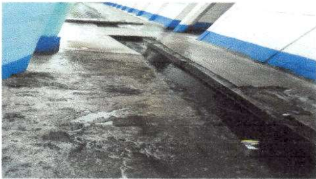
Foto 3: Estado actual del desagüe.
