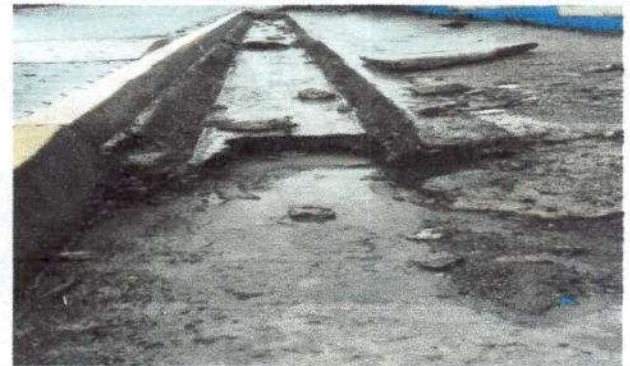
Foto 4: Estado actual del desagüe
